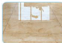
Suelos de baldosas
